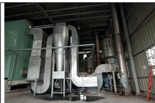
Công đoạn hấp (Lò hơi)
